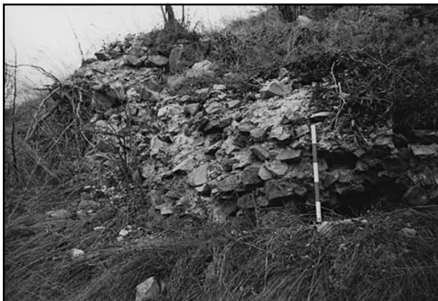
Обр. 16. Част от втората крепостна стена по южния скален ръб. Камъните от лицевата зидария са изпаднали и се вижда пълнежът от ломени камъни, споени с хоросан.
