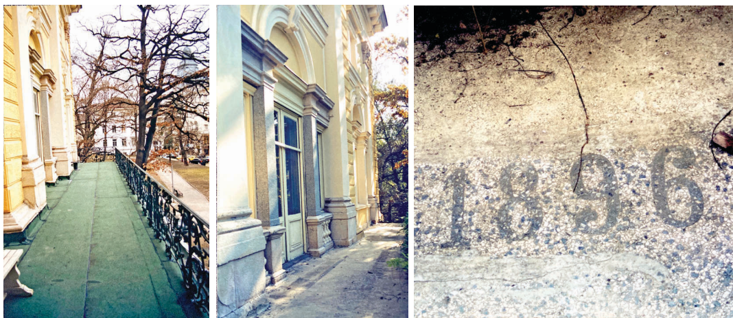
Ил. 2. Южната тераса на втория етаж на североизточното крило на Двореца, 2003 г. Преди и след заличаването на надписа „1896“ и самият надпис (ЕИМ) (Сн. © М. Звѣнчарова)
