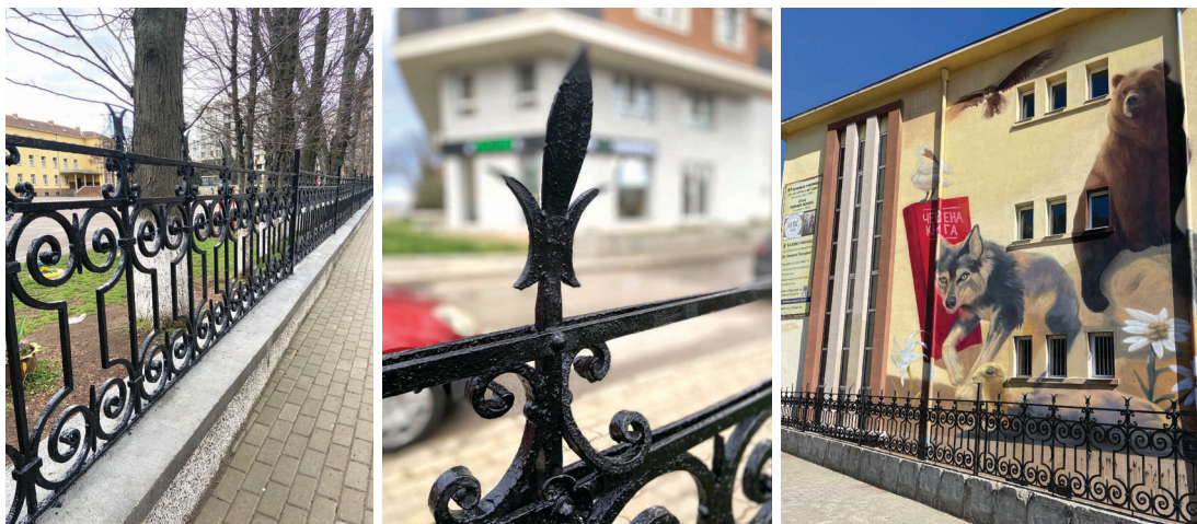
Ил. 1. Оградата на 61-во ОУ, кв. Врѣбница-2, София (април 2023 г.), изградена с части от оградата на Двореца. Детайлът показва силна корозия и деформация на металните части (Сн. © М. Звѣнчарова)
